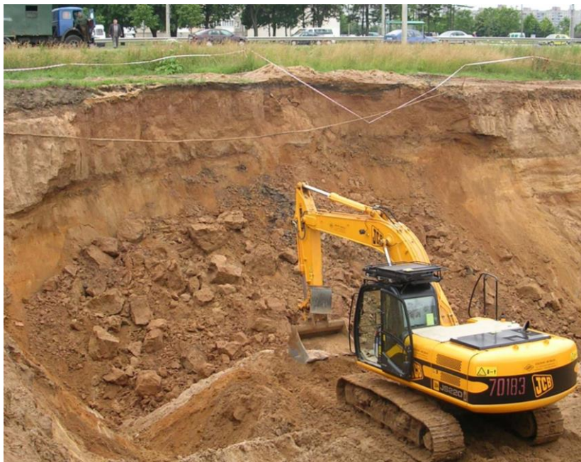
Рис. 6.8. Несортированный материал (дерупций), накопившийся в результате обвала при прокладке трубопровода в микрорайоне Малиновка (г. Минск)
